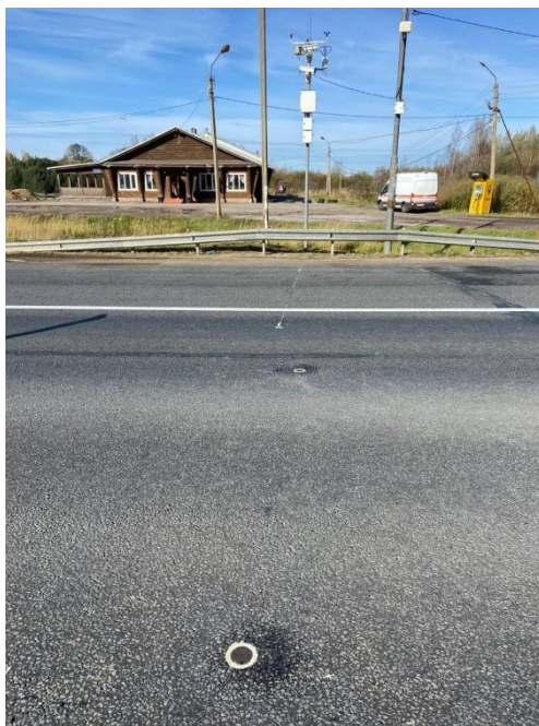
Рис. 6. Автоматическая дорожная метеостанция с датчиком состояния дорожного покрытия
